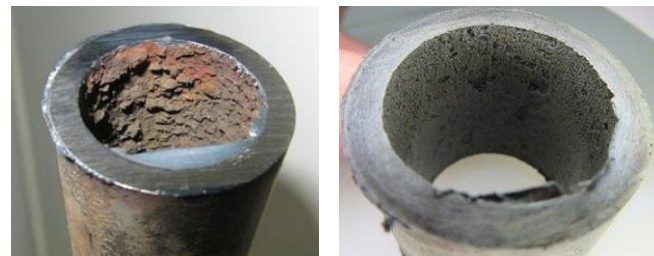
Внешний вид очищаемых поверхностей трубок котла до и после очистки
