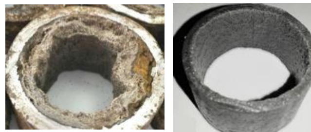
Внешний вид очищаемых поверхностей трубок теплообменника до и после очистки
